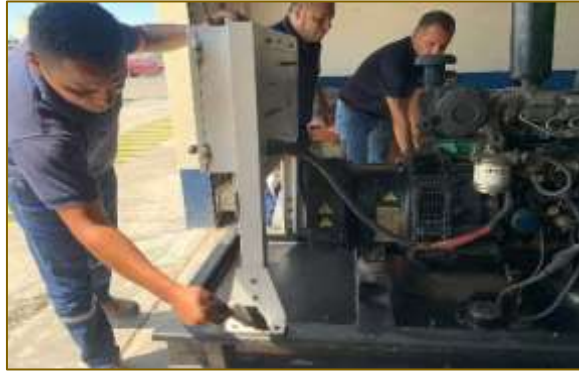
Verificación de fuente de poder/alistamiento de equipos
