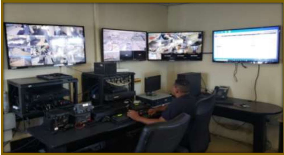
Sala de Control del Circuito Cerrado CCTV
