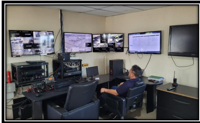
Fotografía No. 1 Sala de CCTV
