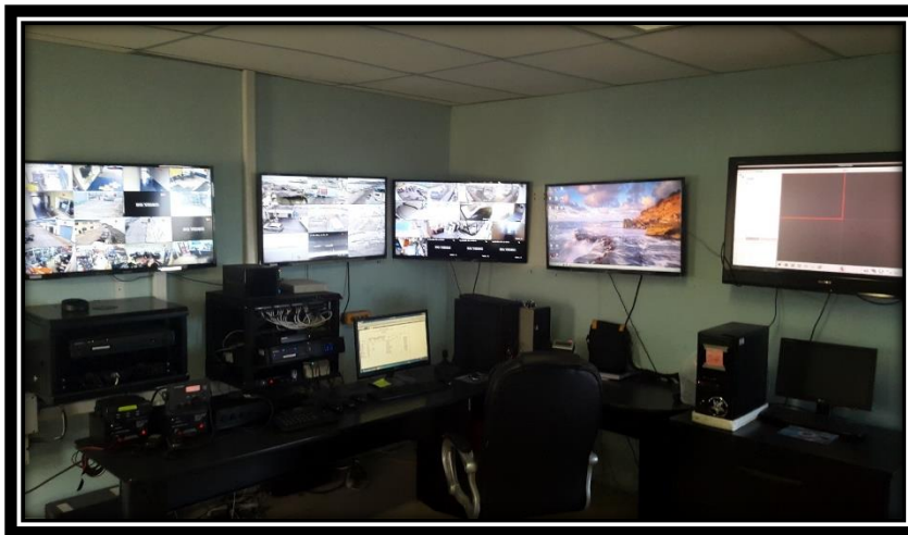
Ilustración 1. Sala de CCTV
